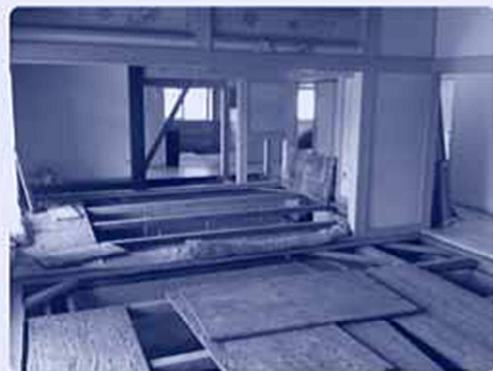
▲泥を被った和室
